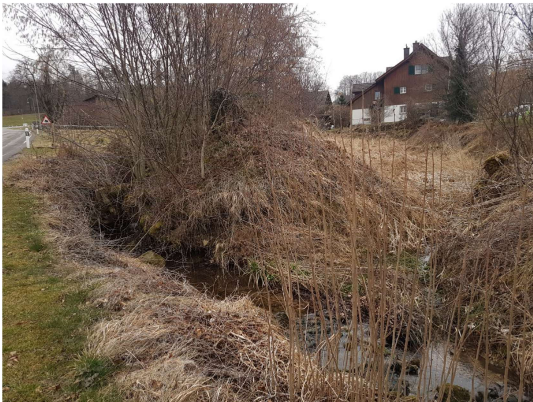
Abbildung 11: Trocken liegender Feuerwehrweiher rechts im Bild, Furtbach von links nach rechts fließend (26.03.2022).
