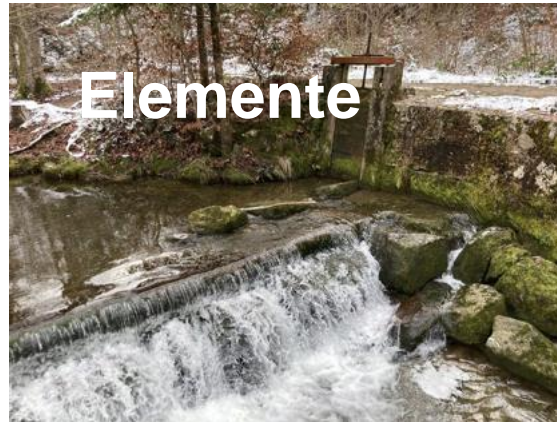
Wasserbauanlagen (Wehre, Leitungen etc.)
