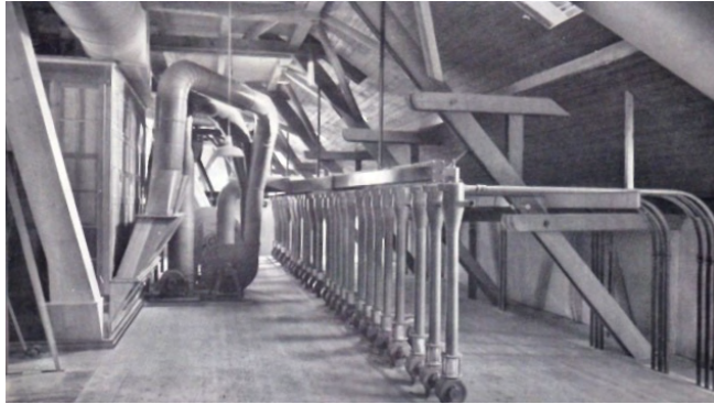
Neue Mühle, Fördersystem © Repro von H.P. Bärtschi, Arias Industriekultur
